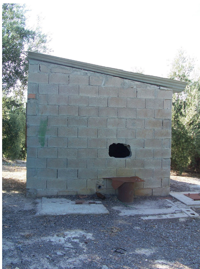
(25) Piezómetro del camino
